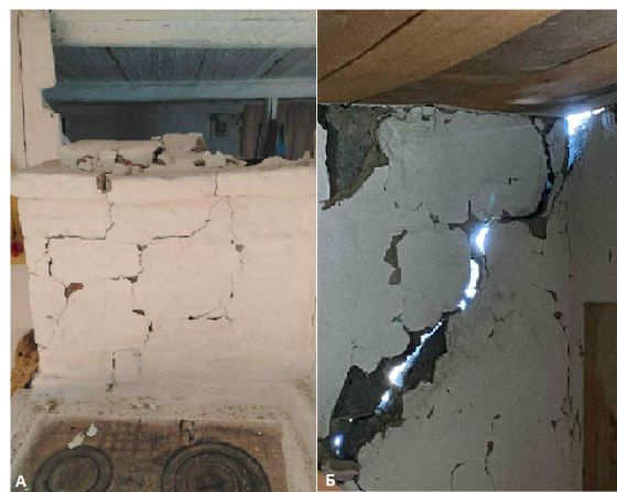
Зураг 2. Газар хөдлөлтийн нөлөөгөөр үүссэн ханын цууралтын байдал: а) гэрийн ханан пийшинд үүссэн цууралт, б) Блокон байшингийн хананд үүссэн цууралт.
